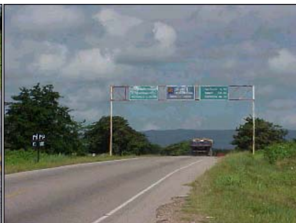
Figura AVP 14. Placa de sinalização vertical (pórtico) pichada
