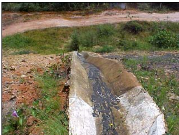
Figura AVP 19. Descida de água do tipo rápida sem manutenção. Erosão na lateral da canaleta
