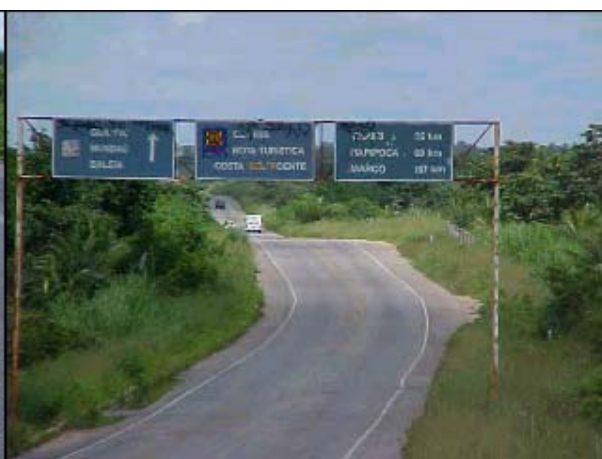
Figura AVP 28. Pórticos enferrujados que serão substituídos
