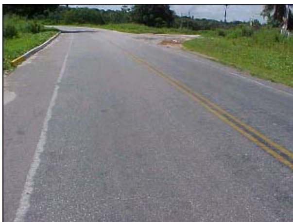
Figura AVP 13. Detalhe do Tratamento Superficial Duplo em boas condições
