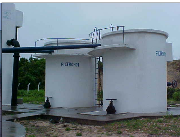
Figura DIB 24. Reservatório com 200 m³ de capacidade, executado com recursos do PRODETUR/CE I, em Trairi
