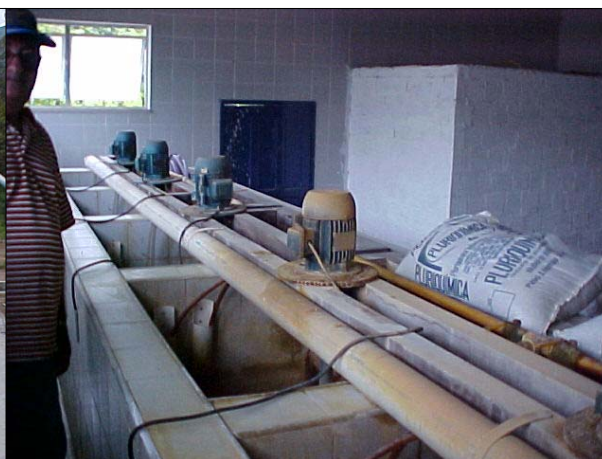
Figura DIB 27. Foto da casa de bombas da ETA de Itapipoca
