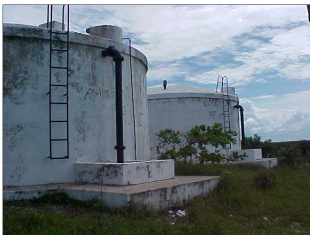
Figura DIB 08. Conjunto de reservação no Distrito de Pecém
