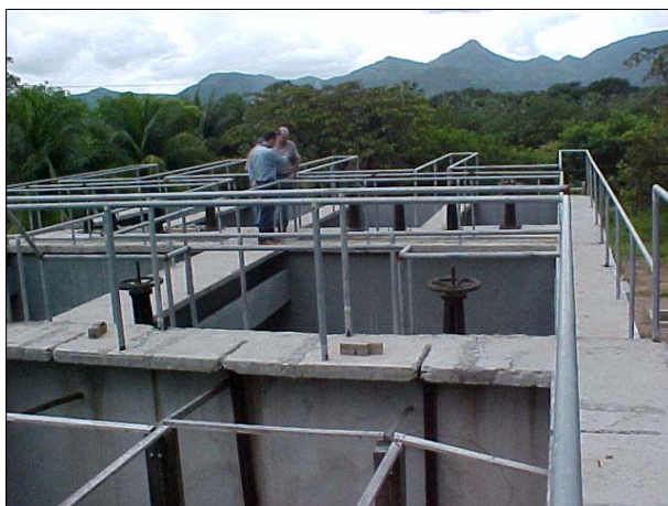
Figura DIB 26. Obras da ETA de Itapipoca sendo executadas com recursos do PRODETUR/CE I
