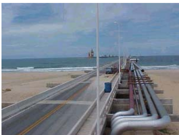
Figura TRA 34. Ponte de acesso aos píeres. Detalhe do suporte para a linha de tubulação
