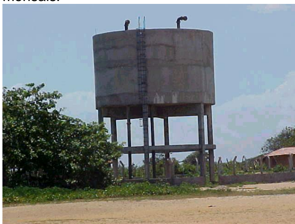
Figura DIB 08. Foto do reservatório de Barra Grande
