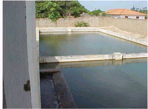
Figura DIB 21. Foto do sistema de decantação e floculação da ETA do Morro da Mariana
