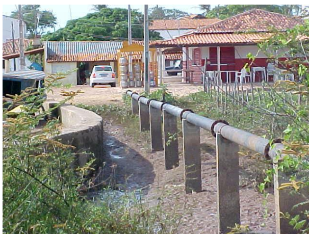
Figura DIB 18. Foto da adutora de água bruta do Rio dos Tatus
