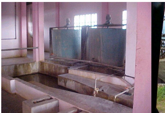
Figura DIB 13. Foto da sala de aplicação de sulfato de alumínio da ETA-IV de Parnaíba
