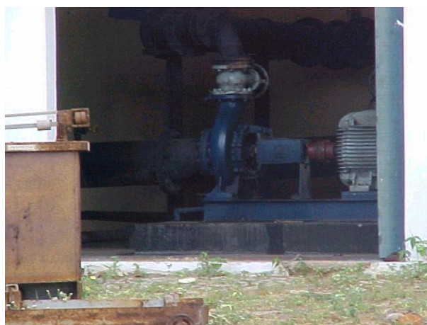
Figura DIB 17. Foto do sistema de bombeamento da ETA-I de Parnaíba
