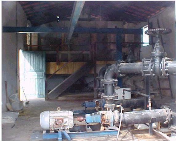
Figura DIB 20. Foto do sistema de bombeamento da ETA do Morro da Mariana
