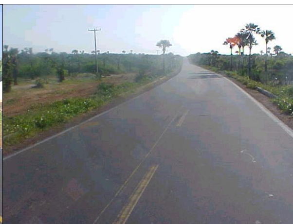
Figura DAT 36. PI – 210 / BR - 402, pavimento em condições razoáveis
