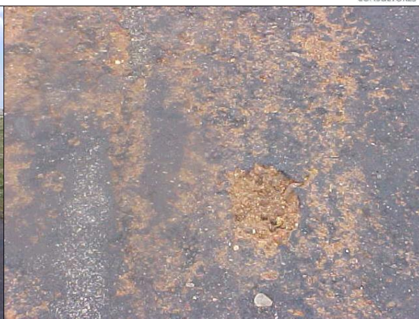
Figura DAT 28. PI-315, capa asfáltica deteriorada
