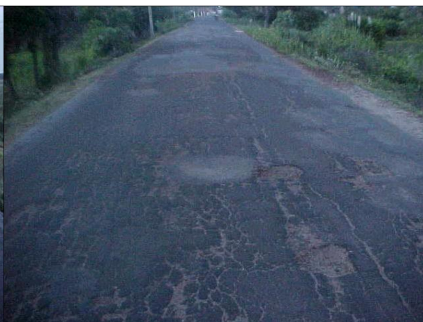
Figura DAT 30. Ligação Ilha Grande – PI – 116 (4km. de Parnaíba), pavimento 118 precário
