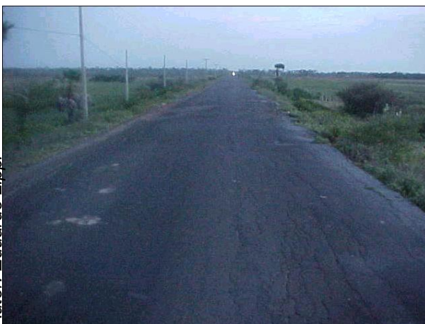
Figura DAT 29. Ligação Ilha Grande – PI – 116 (4km. de Parnaíba), não existe acostamento
