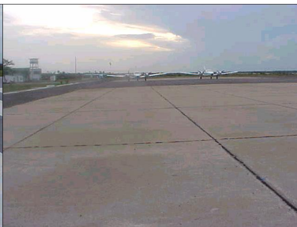
Figura DAT 47. Pátio de estacionamento de aeronaves em pavimento rígido, com esborcinamento nas juntas
