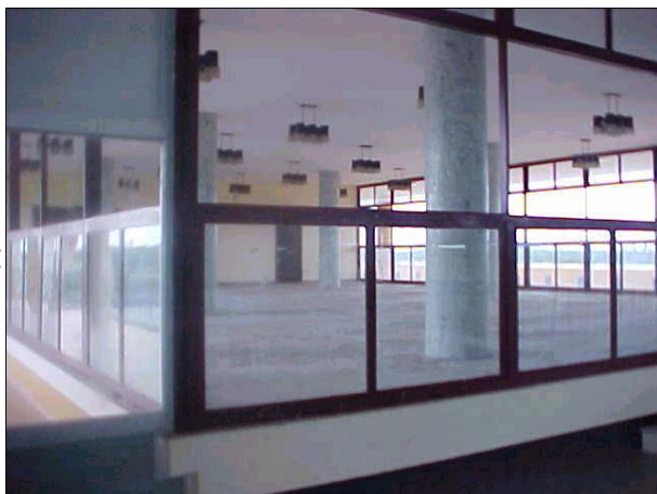
Figura DAT 48. Área destinada ao restaurante, atualmente desativada e necessitando de reformas
