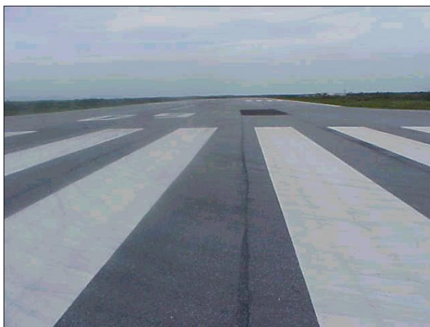
Figura DAT 46. Pista de pouso em pavimento asfáltico, sinais de trincas longitudinais
